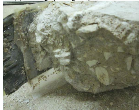
(d) Severe end damage on C-152-A100
