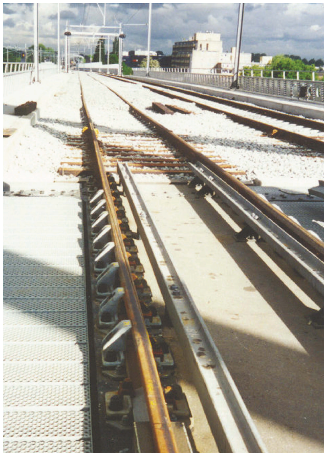
Bild 16 — Spezieller Schienenauszug bei einer Festen Fahrbahn
