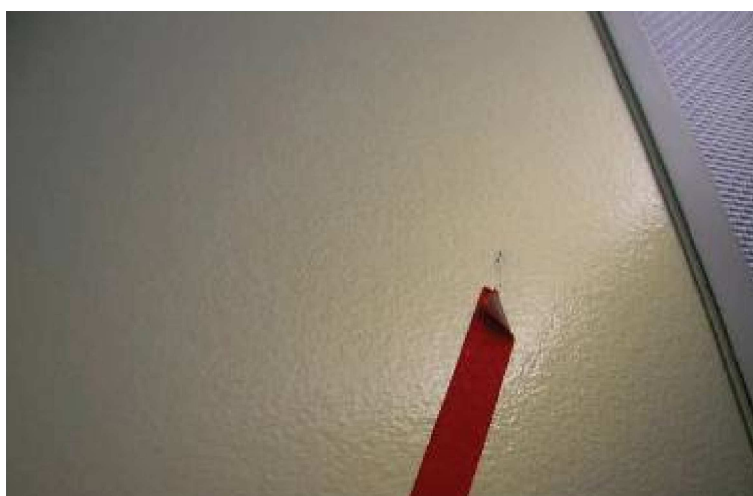
Bild A.4 — Beispiel eines Mangels im Beschichtungsstoff
