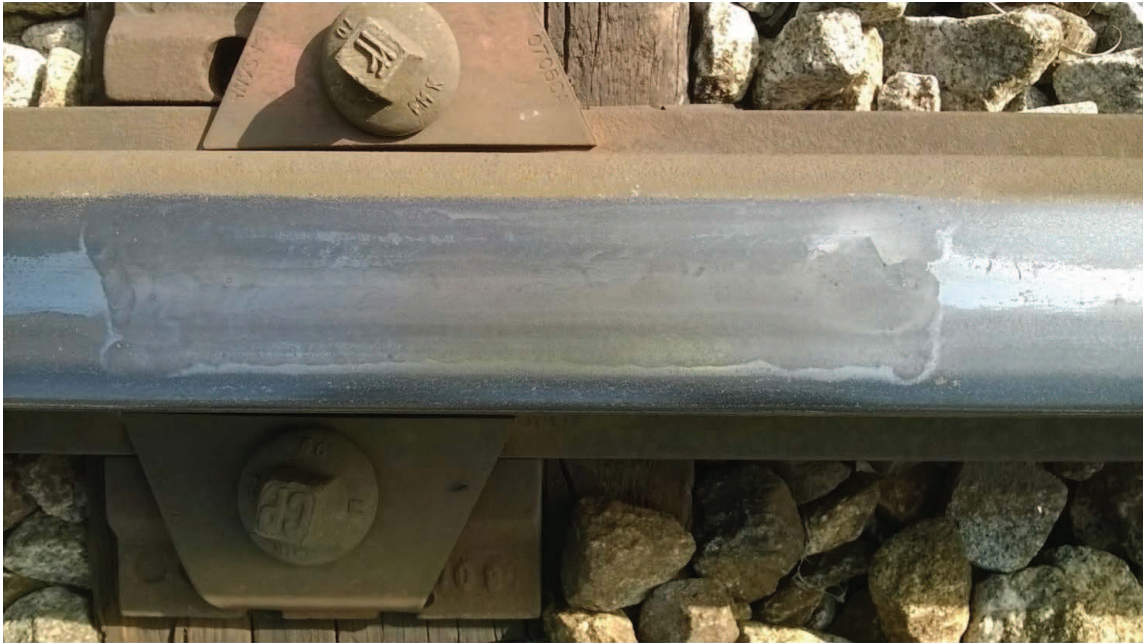
Bild 2 — Porosität an Lichtbogen-Reparaturschweißungen (b)
