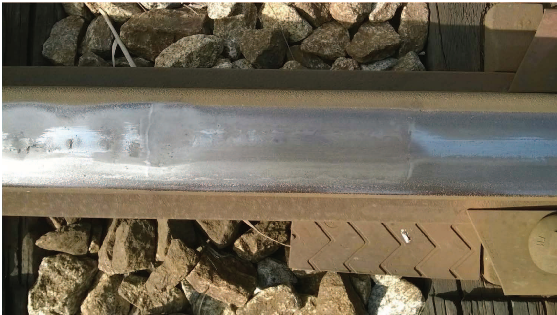
Bild 1 — Porosität an Lichtbogen-Reparaturschweißungen (a)
