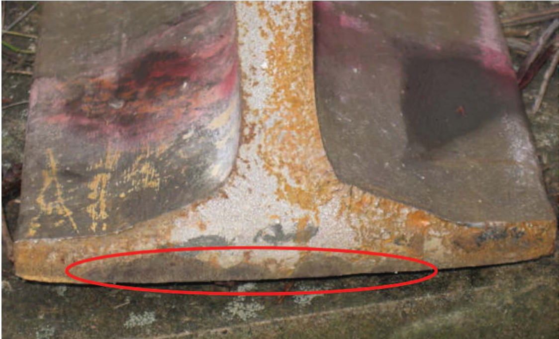
Bild 6 — Querschweißungsfehler in der Trimetallzone (a)
