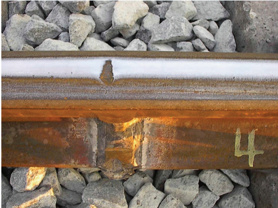
Bild 16 — Querriss im Werkstoff der Oberflächenschweißung (b)
