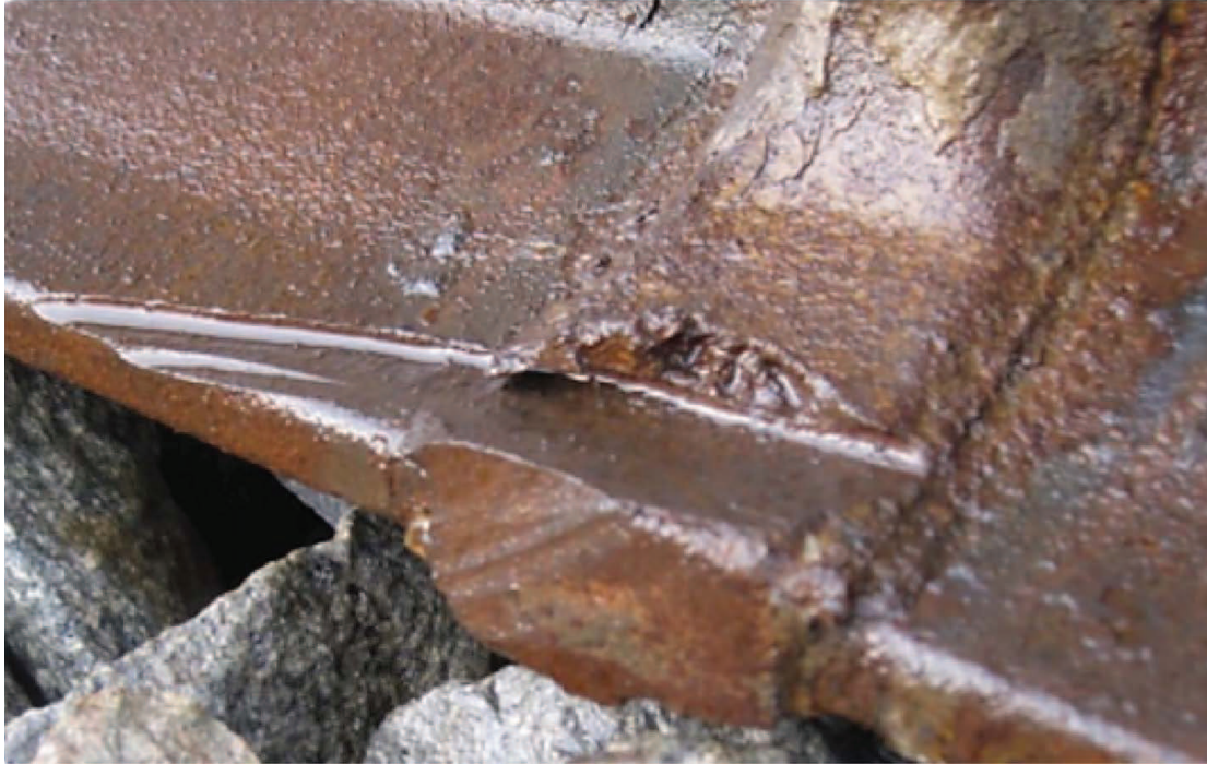
Bild 17 — Beschädigung der Schweißwulst am Steigrohr
