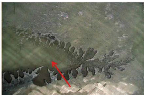
Bild B.2 — Bereiche mit fehlendem Kontakt
